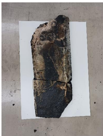
落下していた目地材
