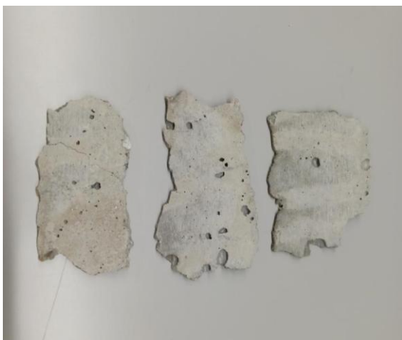
落下していたモルタル片
