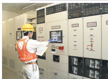
▲電気区での業務は主に「電力設備の保守管理(架線、駅の照明、変電所など)」と「信号通信設備の保守管理(信号機、踏切、列車無線、駅の自動案内放送など)」に分かれる。
